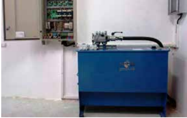
Şekil 1. Hidrolik asansör kontrol panosu ve hidrolik ünitesi [1].
